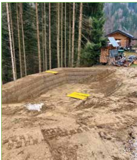
Gut geplanter Hochwasserschutz für die Bewohner unter dem Schattenberg
